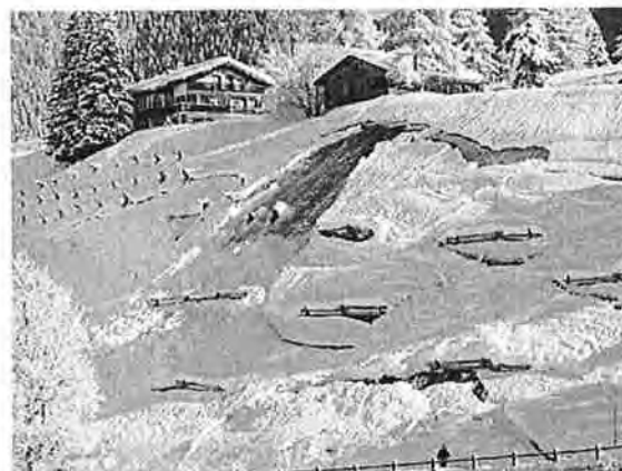
Schneegleiten in einer bestehenden Verbauung, oberhalb Gässeliweg, Wiesen. (Foto M. Hubert)
