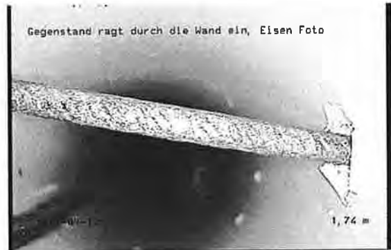
Mangel an einer Abwasserleitung durch eingedringenes Armierungseisen
