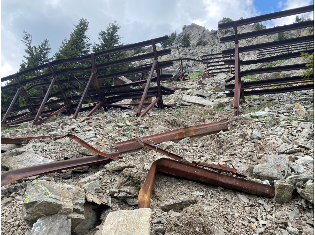
Abbildung 2: Zerstörtes Stützbauwerk SBK Nr. 51 und anschliessend verfüllte Schneenetze.
