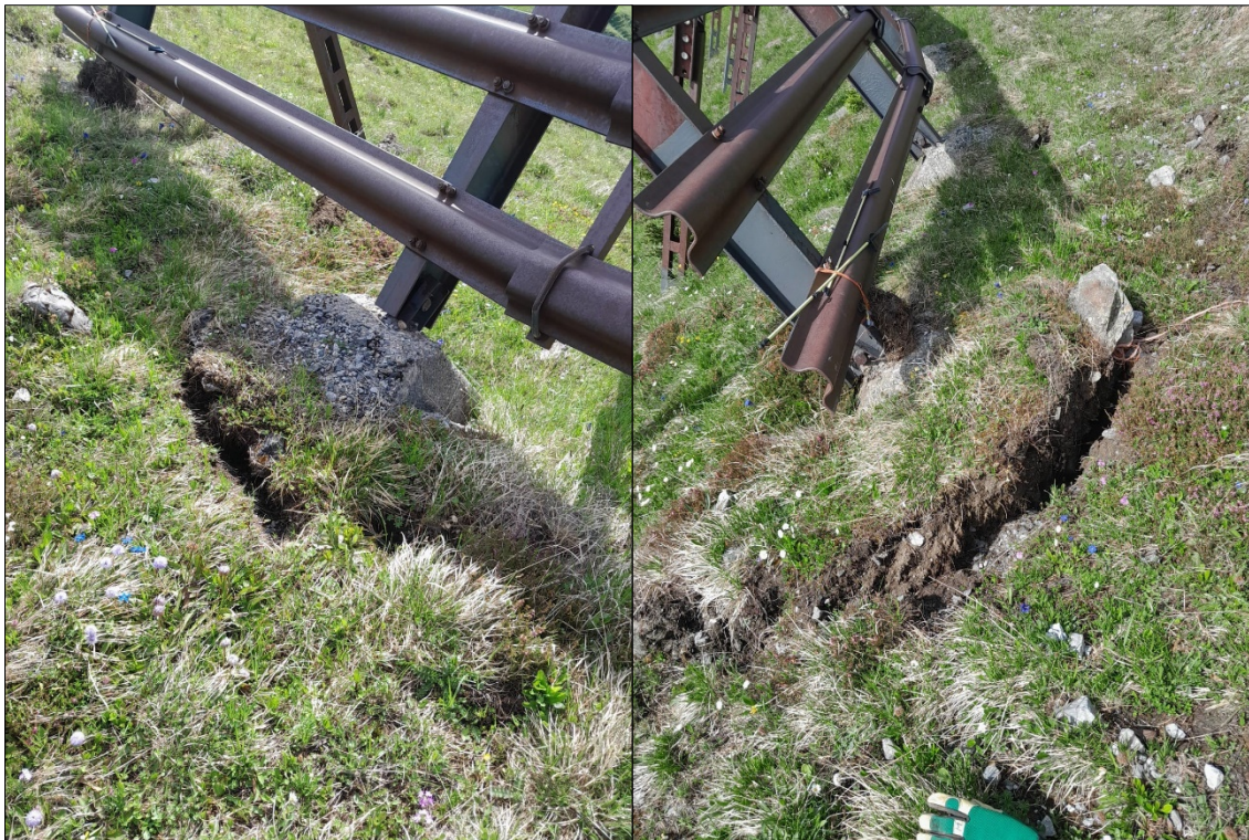
Abbildungen 5+6: Schäden an den Fundamenten.
