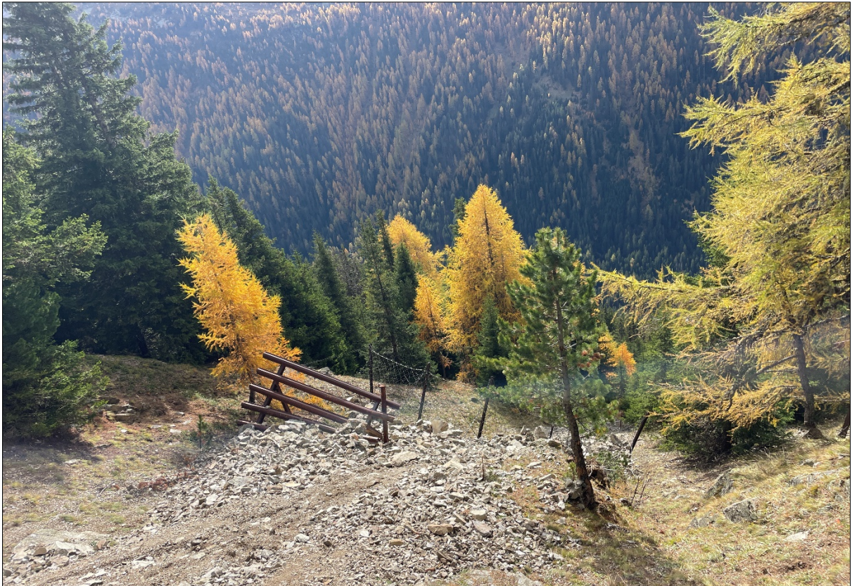
Abbildung 1: Zerstörtes Stützbaumwerk SBK Nr. 51
