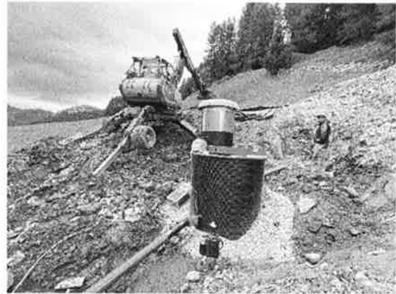
Die neue Brunnenstube im Quellgebiet Flüela
