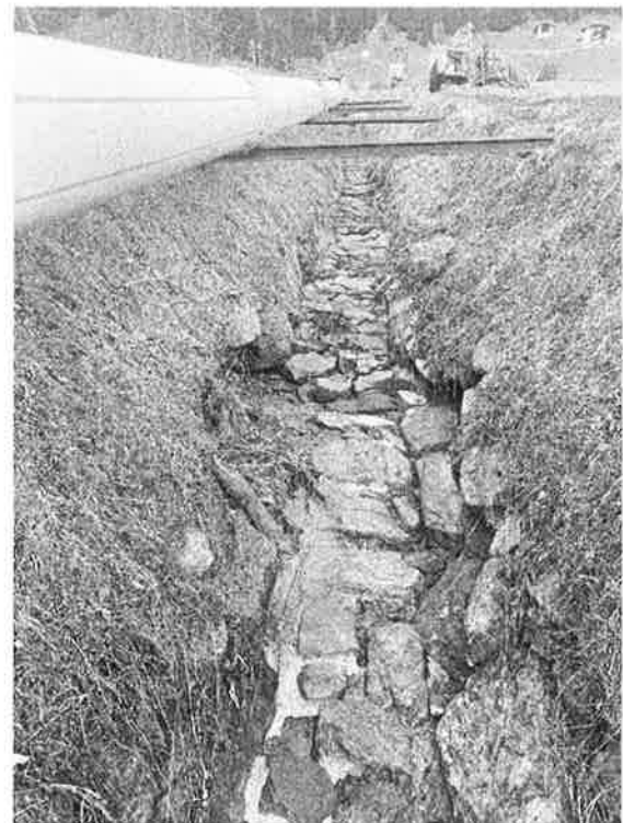
Kanal mit Schadstelle und sauberer Wasserhaltung
