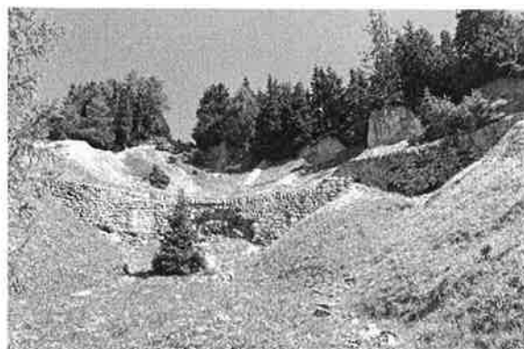
Schadhaftes Sperrbauwerk in einem Seitengerinne unter der Lochalpstrasse
