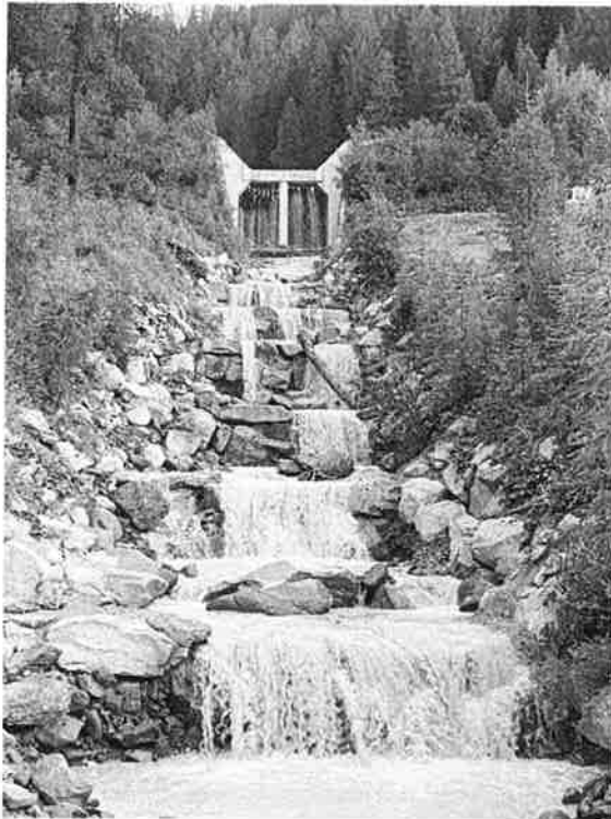
Chummerbach unterhalb des Geschiebesammlers mit defekten Blocksteinsperren
