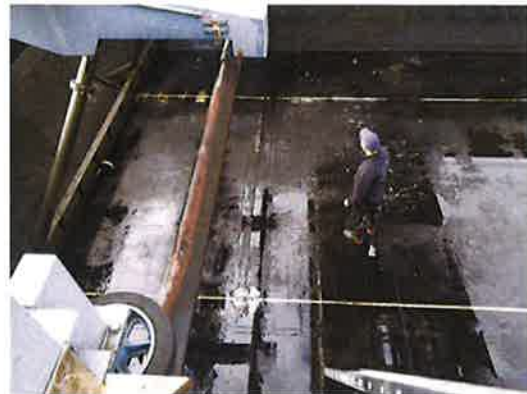
Vorklärbecken Strasse II
