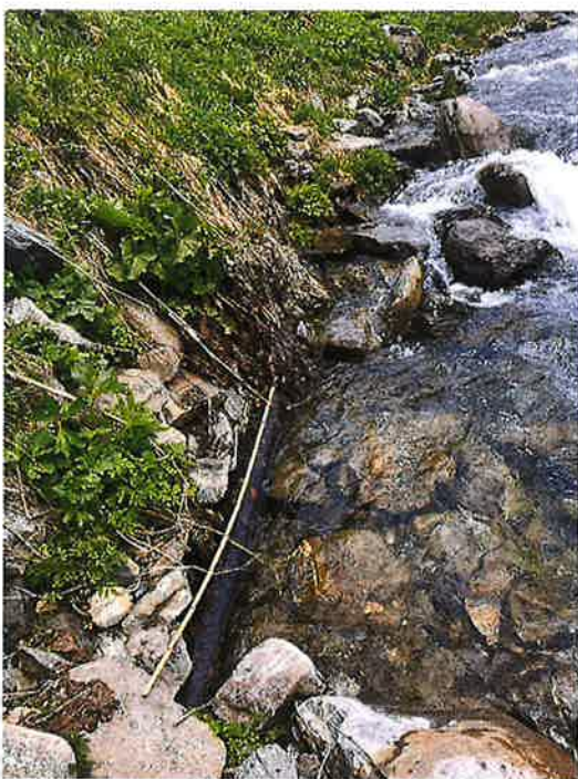
Freigespülte Transportleitung in Flüelabach
