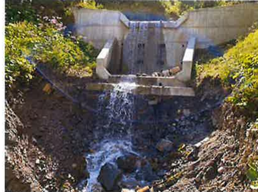
Unterspültes Sperrbauwerk im Bildjibach (Foto: MH)
