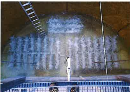
Kontrolle Sauerstoffeintrag in Biologie Becken
