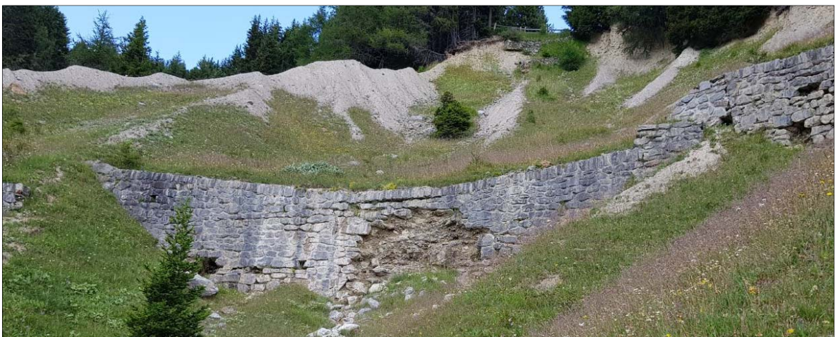
Schadhaftes Sperrbauwerk, Bild Technischer Bericht DIAG
