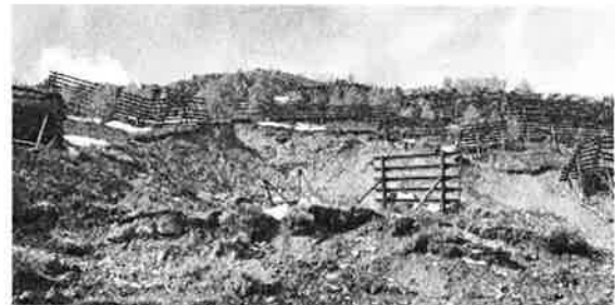
Rutschung Lawinenverbauung Duchli am 17. Juni 2019
