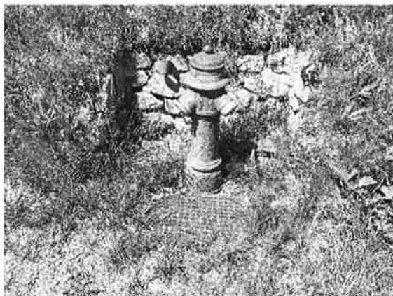
Alter Hydrant auf der Schatzalp, der im 2019 durch einen Neuen ersetzt wurde.
