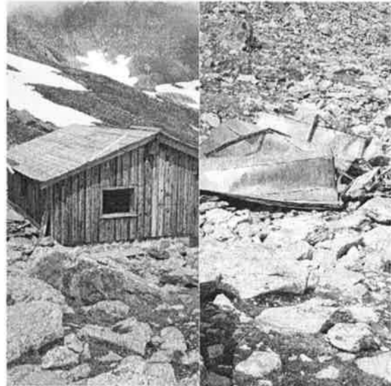
Beschädigte Schutzhütte am Scalettapass
