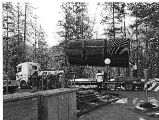
ARA Wiesen, Verlad eines defekten Scheibentauchtropfkörpers zur Entsorgung
