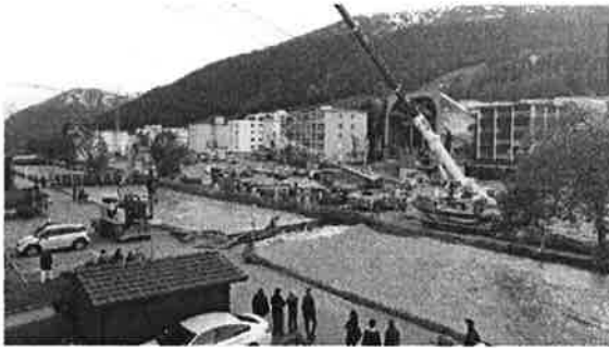
Zusammen mit dem örtlichen Gewerbe wird die Brücke an der Skistrasse entfernt.
