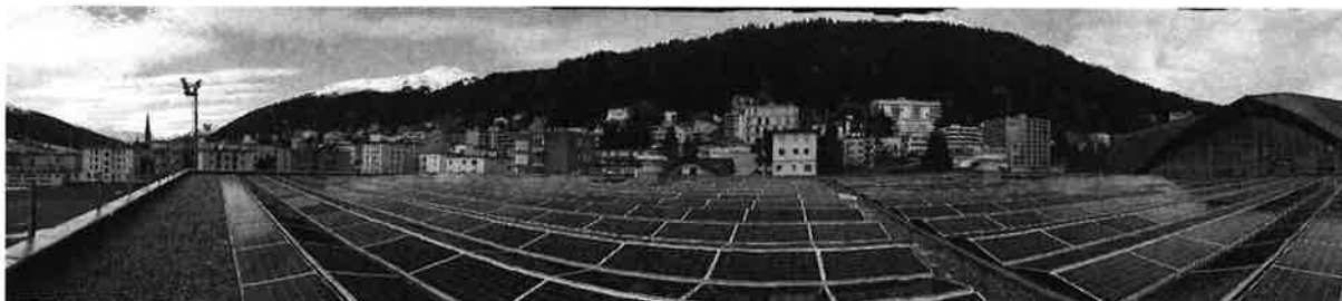
Photovoltaikanlage auf dem Dach der Trainingshalle des HCD
