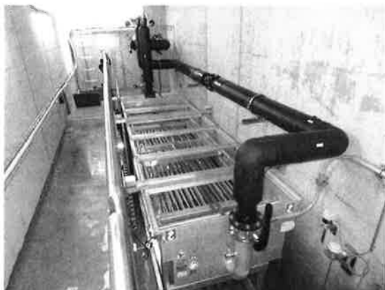
Herzstück der Anlage: Wärmetauscher im Seitenkanal des gereinigten Abwassers
