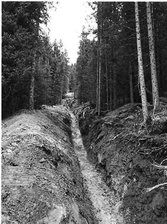
Trasse für die neue Wasserleitung ab der Forststrasse (oben) in Richtung Mattawald
