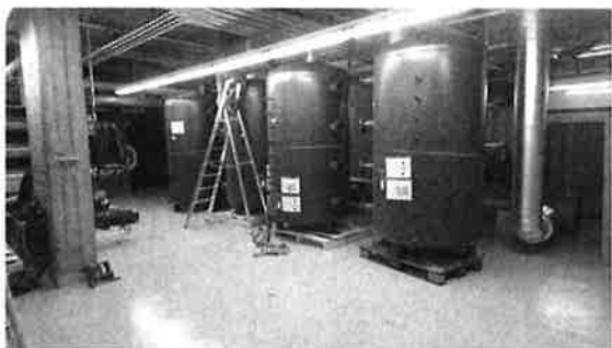
Vier Wärmespeichertanks à 2'800 Liter
