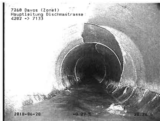
Stark zerrissene deformierte Schmutzwasserleitung mit Infiltration von Saubermwasser. Die Leitung muss dringend ersetzt werden.
