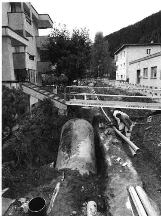
Gesamterneuerung Wildenerstrasse (aufgefundener Öltank)
