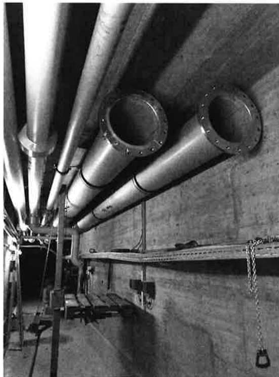
Ansicht der beiden neuen Rücklaufschlammleitungen
