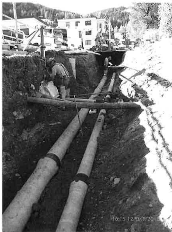
Wasserleitungen in der Ducanstrasse
