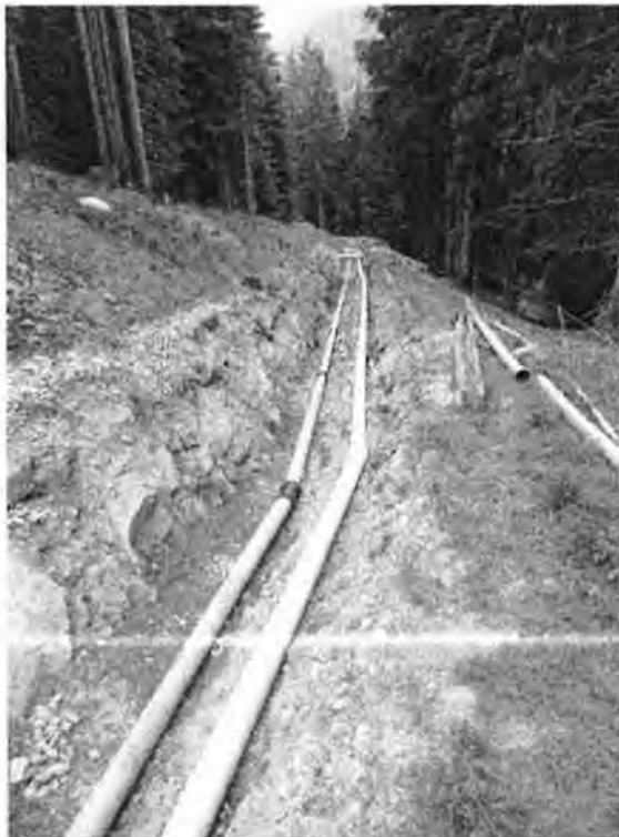
Trinkwasserleitung (blau) und Entleerungsleitung in Richtung Quartier Büelen
