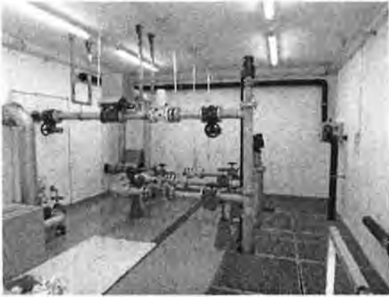
Blick in das Reservoir mit den unzähligen Leitungen und Armaturen
