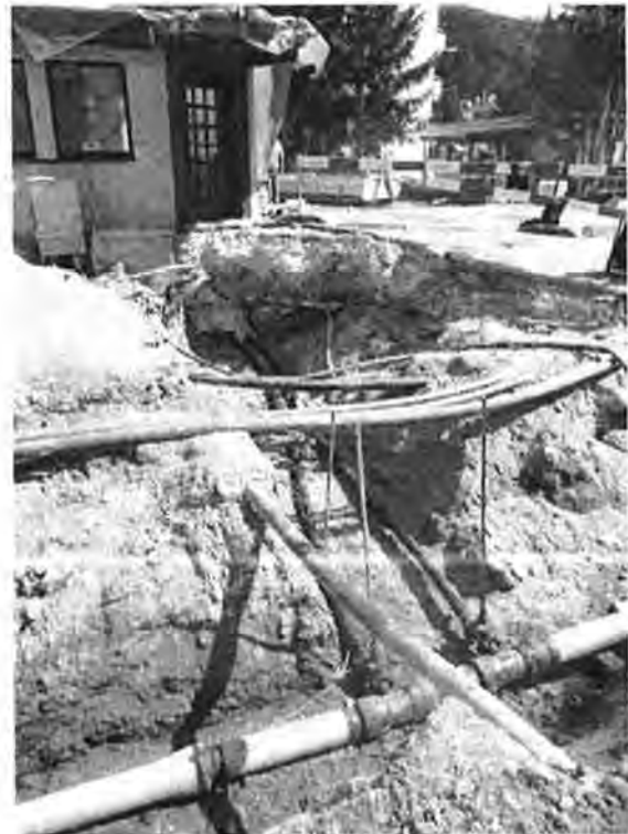
Hausanschluss an der Eisenbahnstrasse
