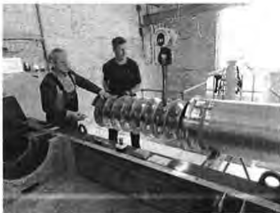
Einsetzen der Trommel in die Zentrifuge durch Mitarbeiter der ARA und Spezialisten
