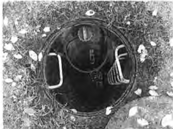
Fertig installierter Prozesswächter in einem Kontrollschacht
