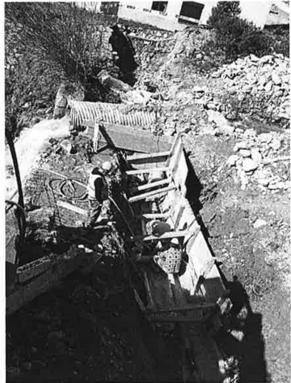
Albertibachquerung mit der Wasserleitung – im Hintergrund wird der Albertibach durch das grosse Rohr um die Baustelle geführt
