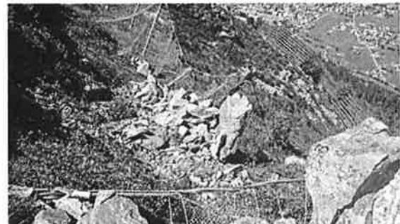
Lawinerverbauung Duchli, beschädigtes Schneenetze
