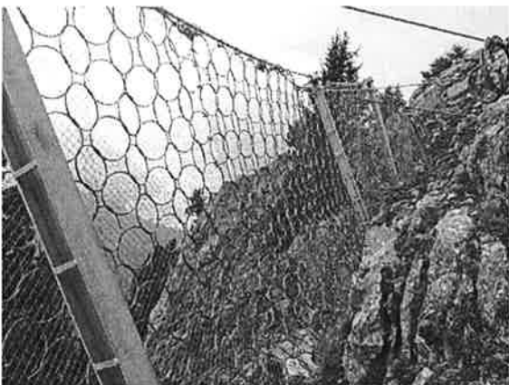
LV Seehorn, eine Netzverbauung sichert die Ausbruchsstelle vom Felssturz 2013 (H. Hefti)
