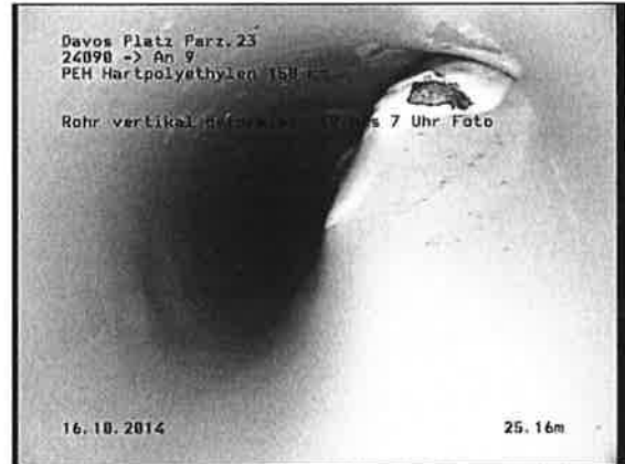
Deformiertes Rohr einer Abwasserleitung (festgestellt durch Befahrung der Leitung mit einer Kamera)
