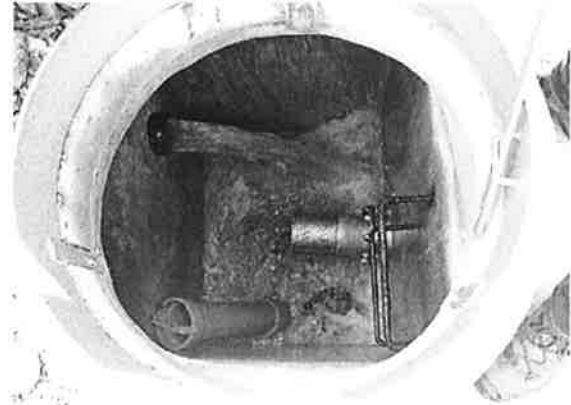
Einblick in eine Brunnenstube bei der Inneralp – links oben Eintritt des Quellwassers – rechts der Auslauf inkl. Filter in Richtung Reservoir Monstein
